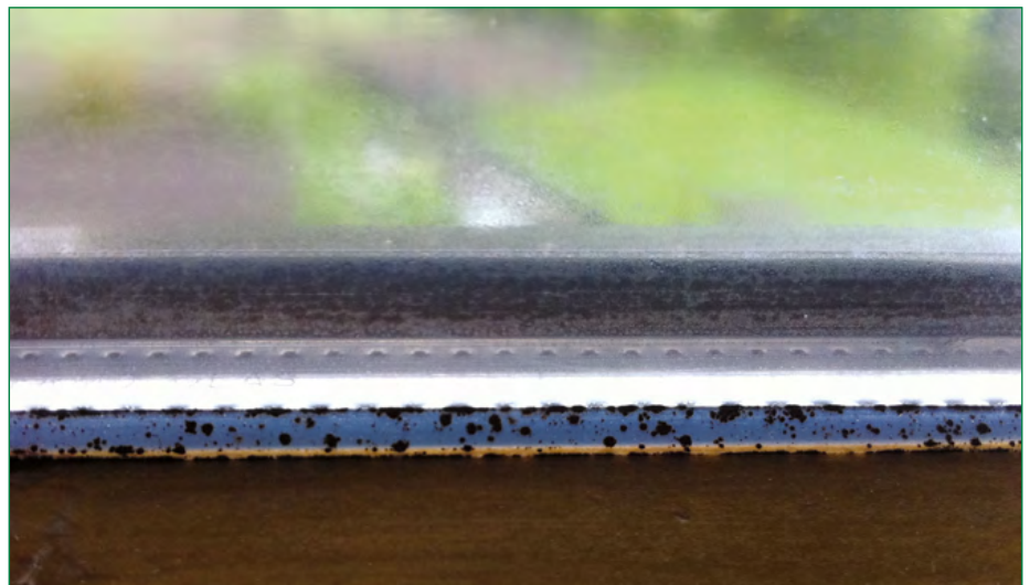
Abb. 4: Längerfristig droht dadurch Schimmelbildung, was nicht nur aus hygienischen Gründen inakzeptabel ist.
